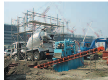
アジテータ洗浄処理状況
