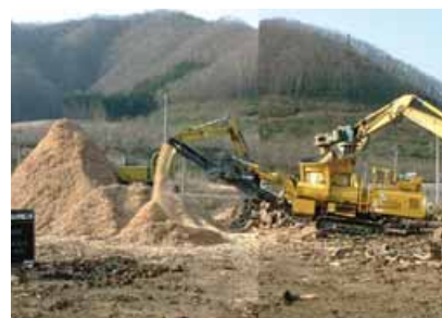
貯木場での破碎状況
