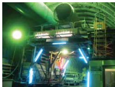
電気集塵機設置状況
