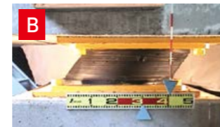
免震装置(積層ゴム)の変形状況
