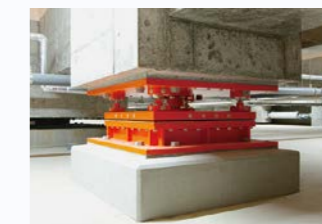
微振動対策ダンパー
