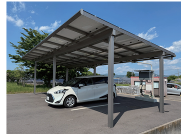
新設したソーラーカーポート
