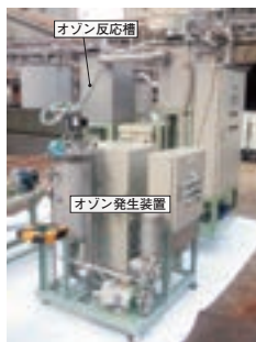
汚染水処理ユニット
