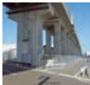
▲ 北陸新幹線 上越・糸魚川地区 保守用設備他 (新潟県上越市～ 糸魚川市)
