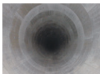
▲公共下水道和田川 排水区2号雨水幹線 工事 (和歌山県和歌山市)
