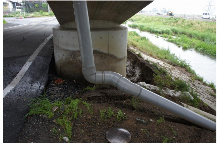
益城：九州自動車道下の液状化
