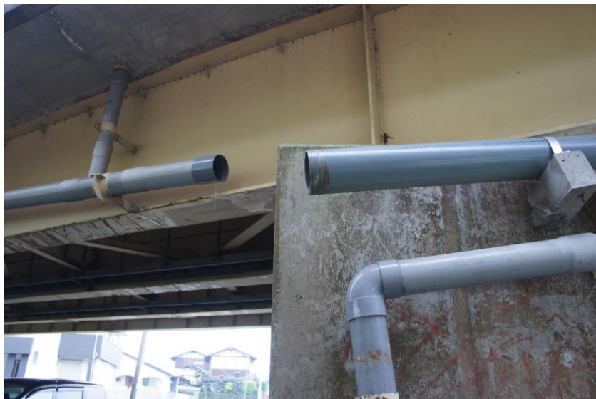
九州自動車道：高速道路添架管の被害
