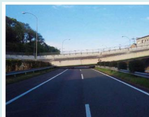
跨道橋の落橋
