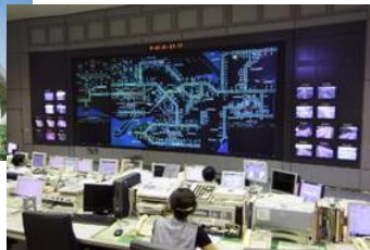
道路管制センター
