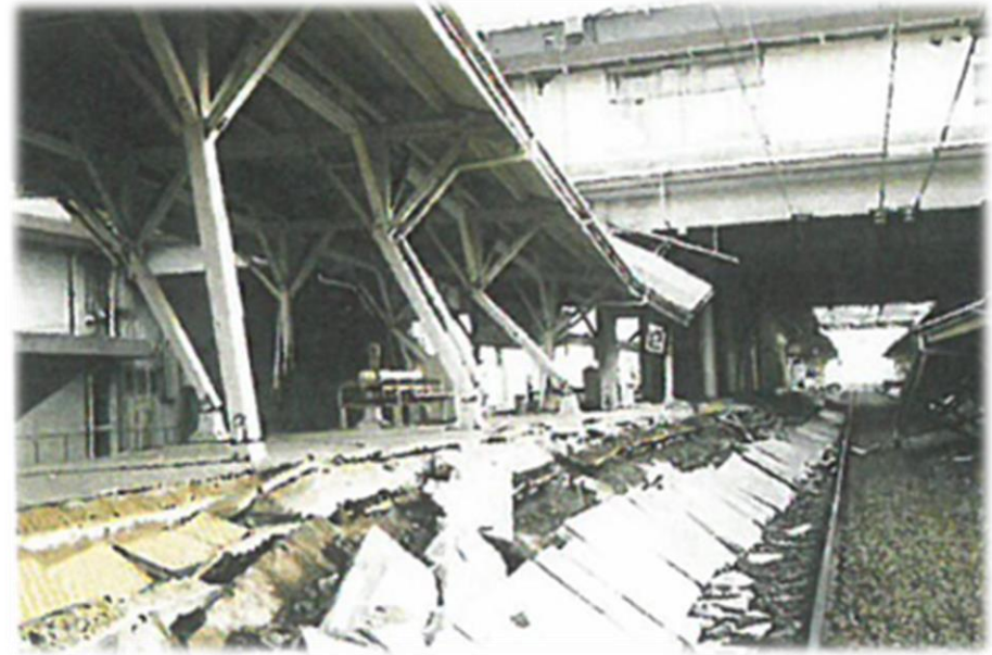
盛土ホームの崩壊、上家の倒壊 (東海道線 芦屋駅)
