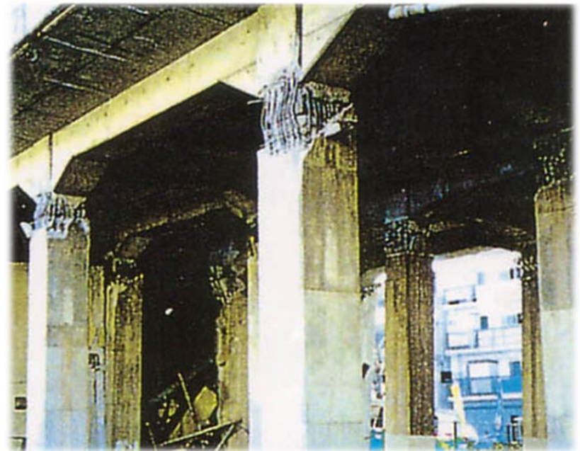
高架橋の変形やコンクリートの落下
