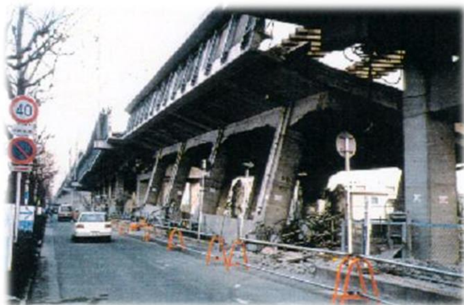
高架橋（山陽新幹線）の倒壊 （新大阪～新神戸 阪水(はんすい)高架橋)
