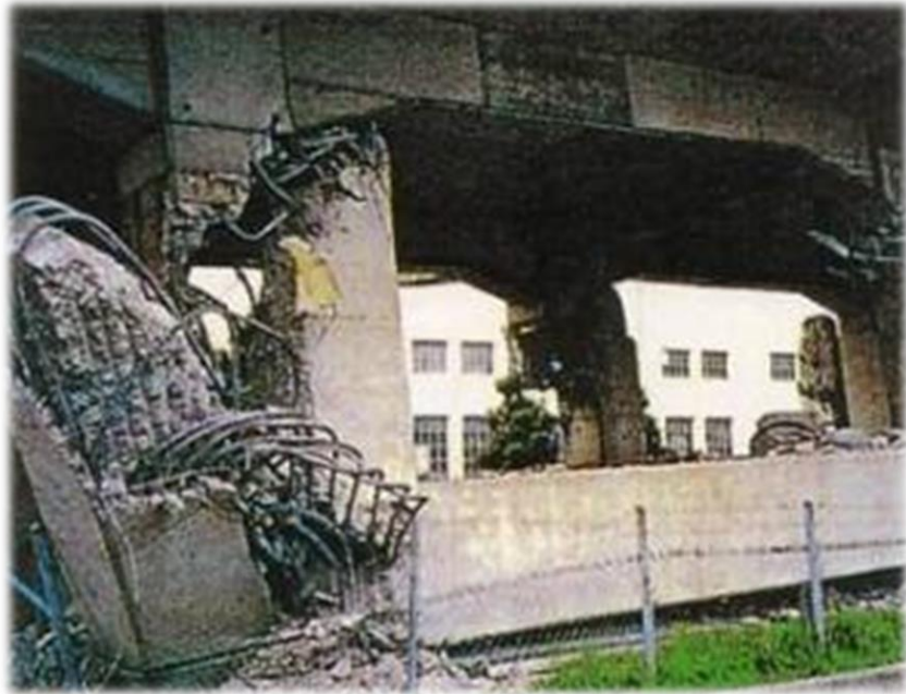
高架橋の倒壊
