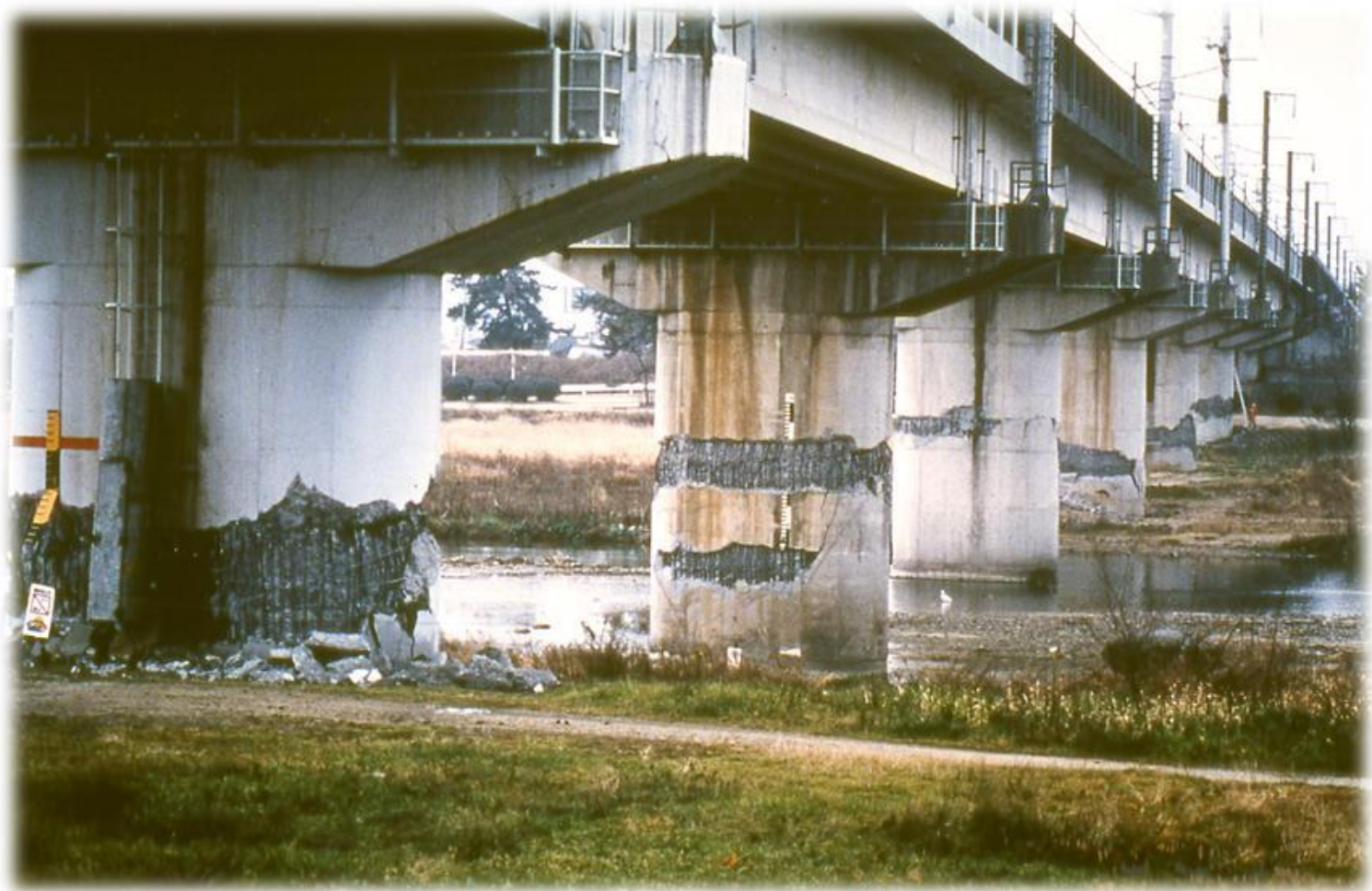
鉄筋コンクリート橋脚の損傷 (山陽新幹線 新大阪～新神戸 武庫川橋りょう)
