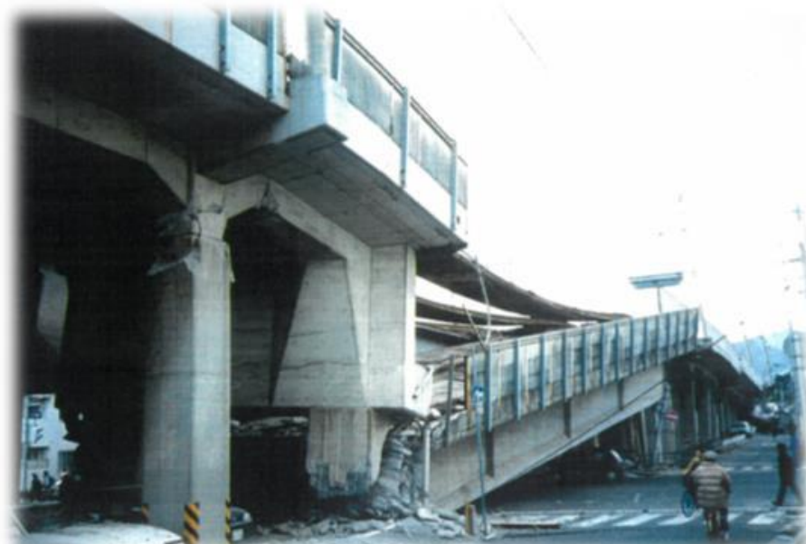
高架橋（東海道線）の倒壊・落橋 （住吉～六甲道 弓場(ゆみば)高架橋)
