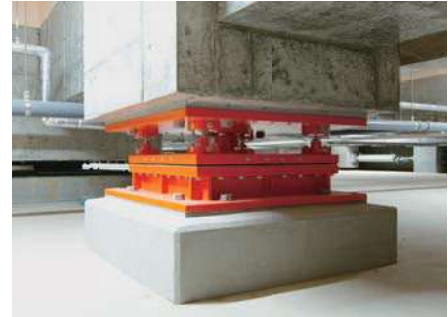
▲微振動対策ダンパー (WSD-3. 2-100:2基設置)
