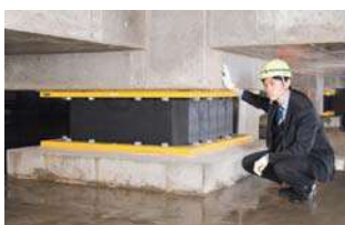
免震装置(積層ゴム)
