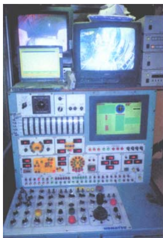
<稼働中のシステム>
