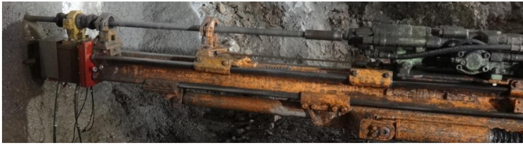
写真-3 ガイドセル先端固定装置付きの油圧削岩機による穿孔状況
