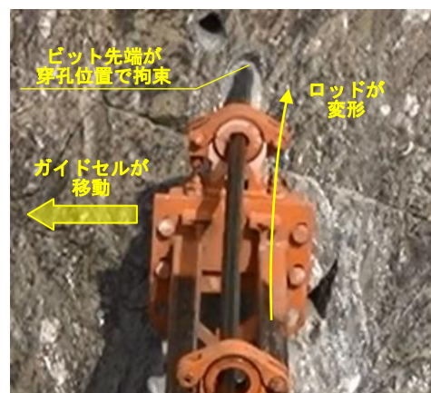
写真-1 ロッド変形状況
