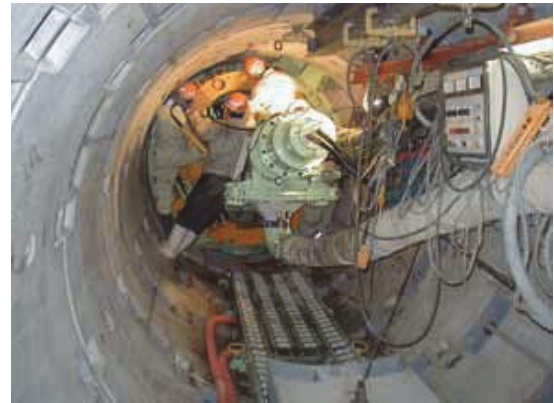
写真-7 スクリュコンベヤの機内設備状況
