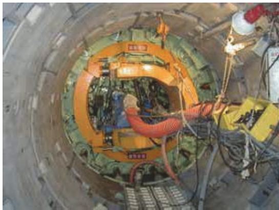
写真-6 新排土システムの機内設備状況
