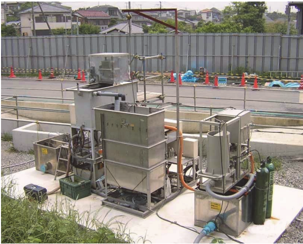
写真-2 実用機設置状況 (Ab トンネル)
