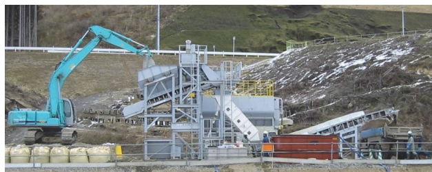
写真-3 CSG混合設備
