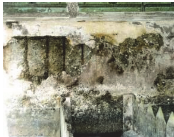
写真-1 下水道施設の劣化状況
