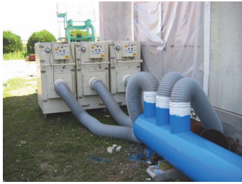
写真-6 集塵機設置状況 (90m³/min × 3台)
