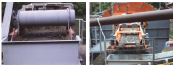
写真-3 前処理設備 (左:振動スクリーン、右:ハイメッシュスクリーン)
