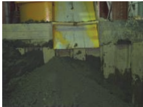
写真-7 脱水ケーキ用土砂ピット状況
