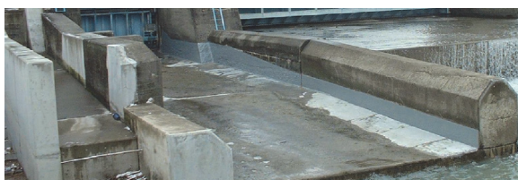
写真-1 頭首工土砂吐水路での事例
