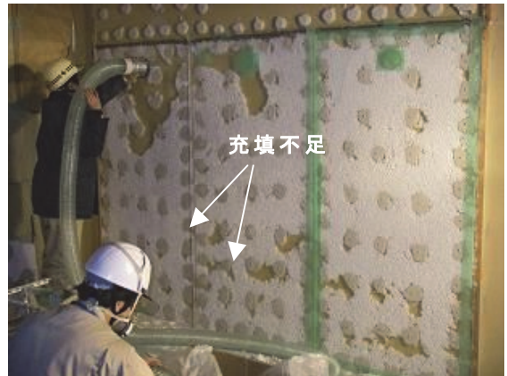
写真-3 GL工法における充填不足
