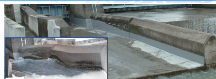
写真-1 頭首工土砂吐水路での事例
