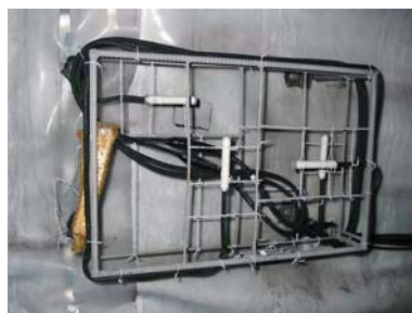
写真-1 計測機器の設置状況
