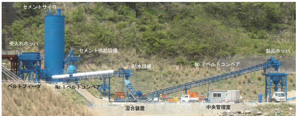
写真-6 CSG混合設備の全景
