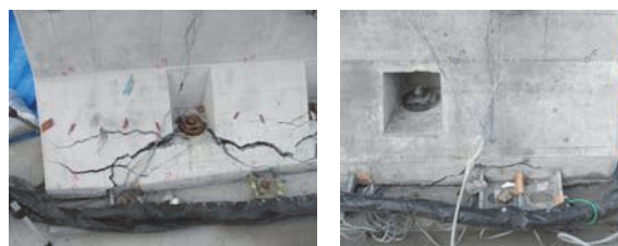
(直壁型 TD-2) (フロリダ型 FS-1) 写真一九 ひび割れ発生状況（載荷高 100 cm）
