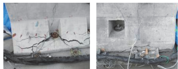
写真一九 ひび割れ発生状況（載荷高 100 cm）
