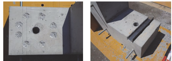
写真-1 接合面の状況
