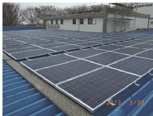
写真-1 太陽光発電パネルの設置状況
