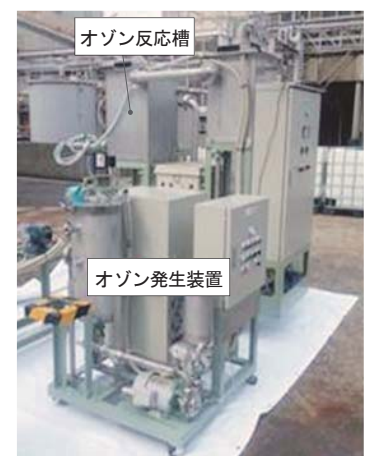
写真-2 汚染水処理ユニット
