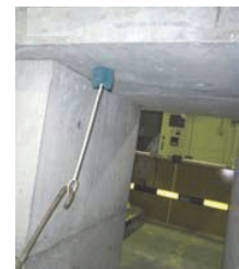
写真-3 吸湿防止状況
