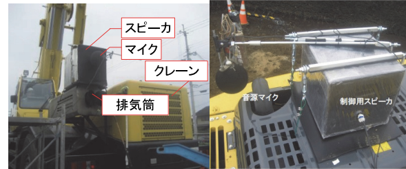
左:ラフテレーンクレーン、右:バックホウ 写真-1 機器の設置状況
