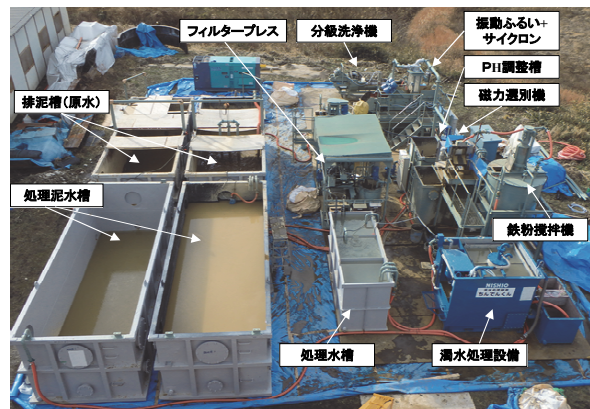
写真-2 実証実験プラント
