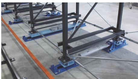
(c) ラック制振の脚部
