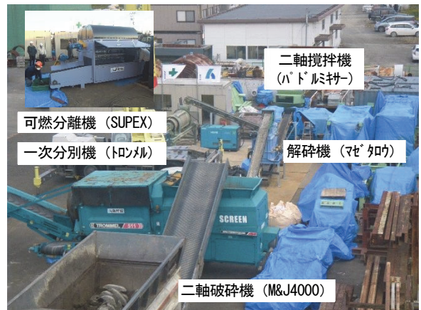
写真-3 実証試験における機器配置状況
