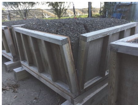
写真-7 木枠が押し上げられた状況
