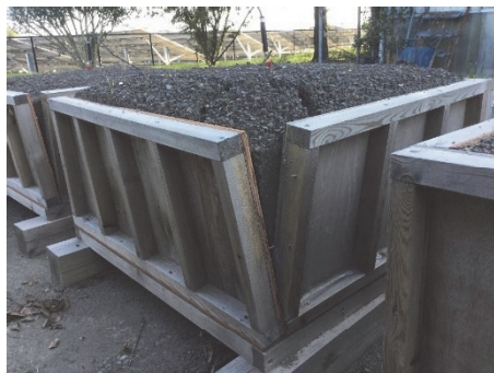
写真-7 木枠が押し上げられた状況
