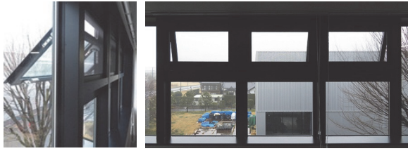
写真-4 北側自然換気窓
