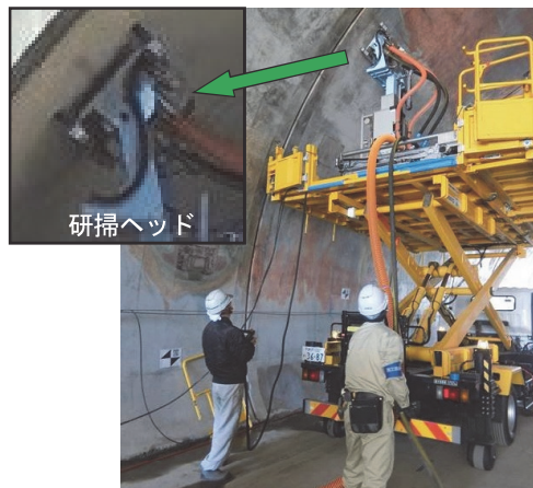
写真一八 性能確認実験の自動化運転状況
