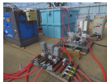
写真-4 設備配置状況
