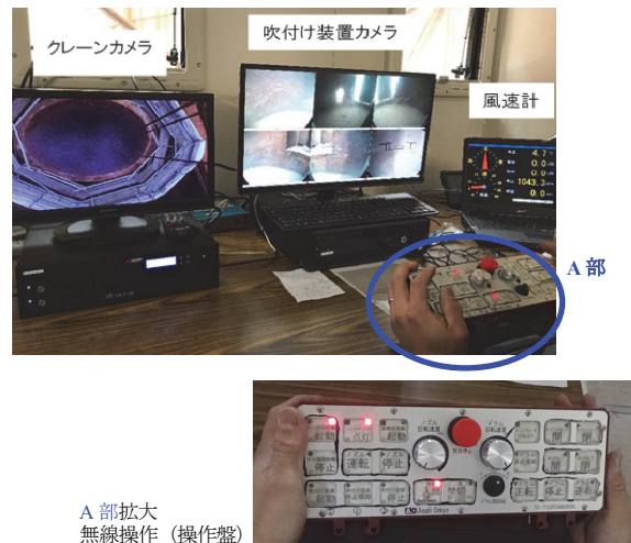
写真-7 無線操作（操作盤）および監視状況
