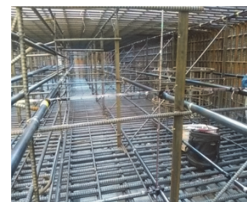
写真-2 クーリングパイプ配置 （システム現場適用時、躯体内）
