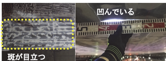
写真-13 仕上がりに斑がある箇所
