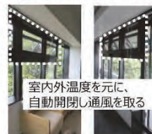
自動制御自然換気窓
