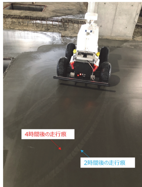
写真-3 金鍍仕上げ後の走行痕確認状況
